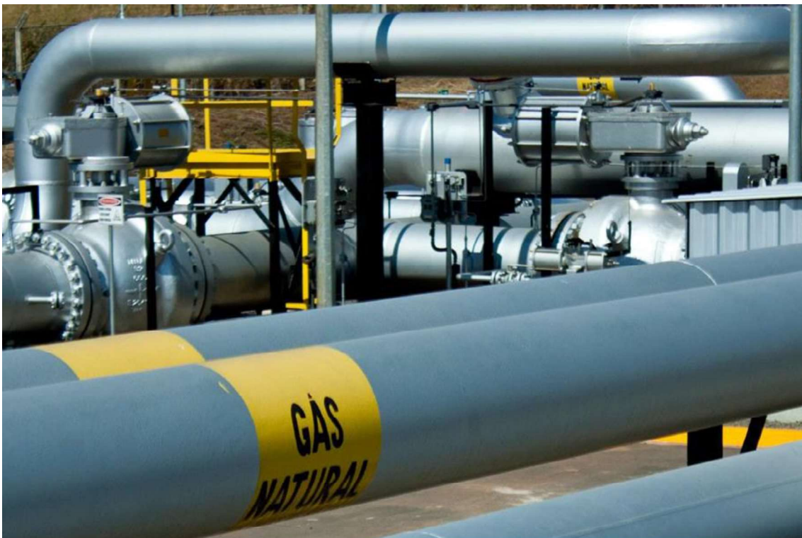
Gasbol (Gasoduto Bolívia-Brasil), da Transportadora Brasileira Gasoduto Bolívia-Brasil (Foto: Divulgação/TBG)
